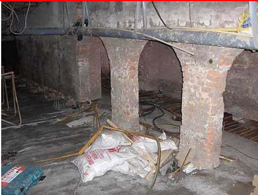
Figuur 20 Spaarbogen bij een fundering waar funderingsherstel wordt uitgevoerd (Rozenhof Dordrecht)
