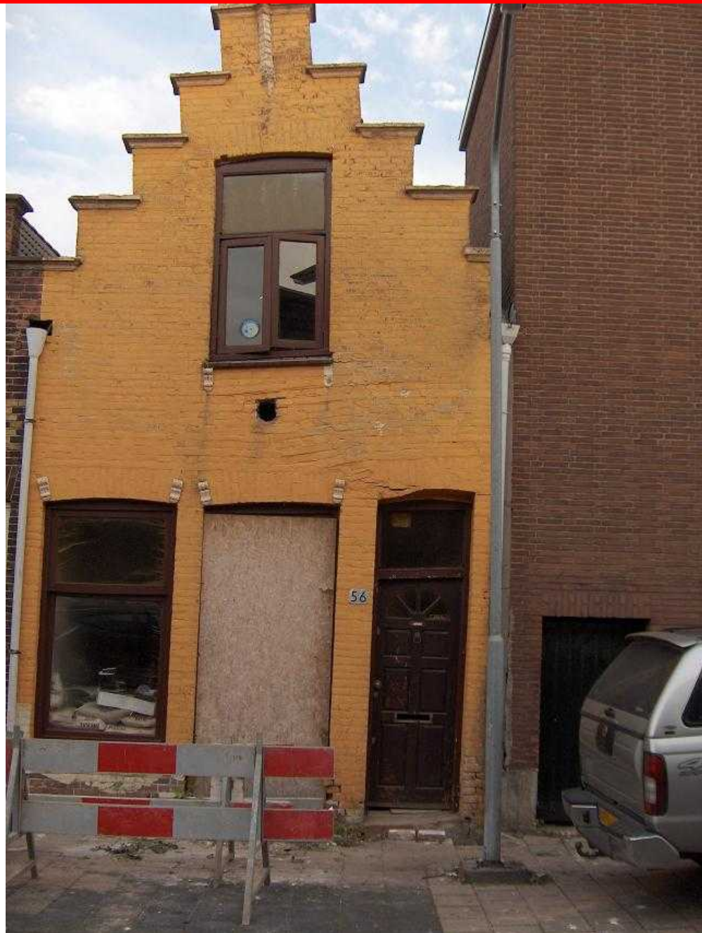
Figuur 02 woning met fundering op staal (geel) vast aan woning met houten palen (rechts). De gele woning hangt aan één zijde aan de naastgelegen woning met funderingspalen en is totaal ontwricht.
