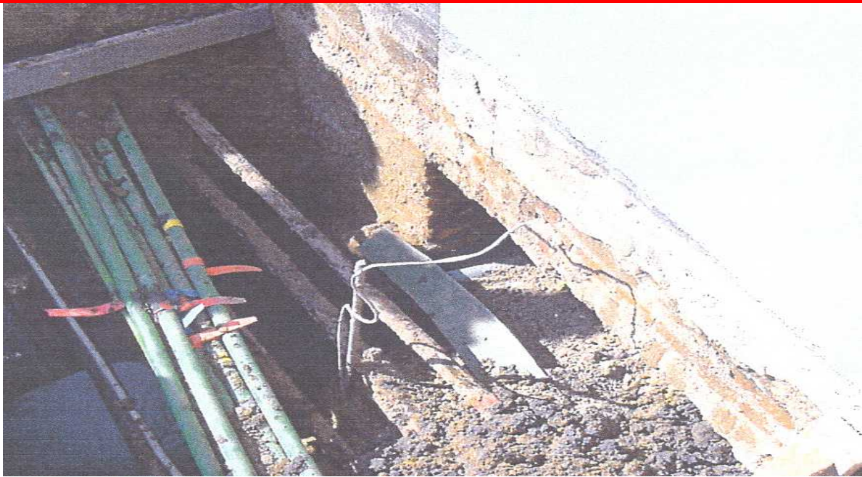
Figuur 31 Diverse kabels en leidingen in het trottoir. Bron foto SPFN
