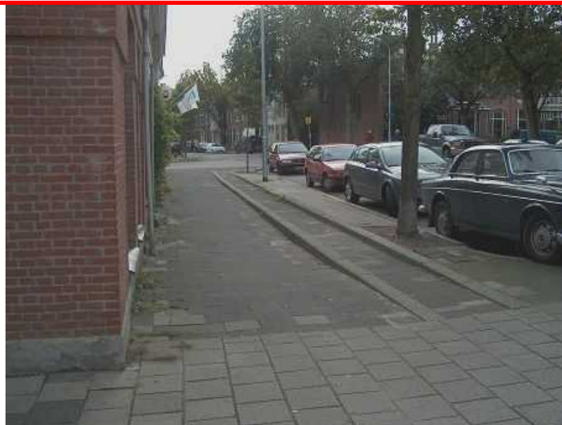
Figuur 06 Woningen op staal die zover zijn gezakt dat het trottoir verlaagd moest worden. Over een aantal jaren zijn nog grotere problemen te verwachten om dat de verzakking door blijft gaan. Op een gegeven moment zijn maatregelen in de openbare ruimte niet meer mogelijk. Let bij kopen er op, dat de begane grondvloer nog voldoende hoog boven het trottoirniveau of de tuin ligt. In dit soort situaties extra letten op water in de kruipruimte, optrekkend vocht en mogelijk rotte balken onder de begane grondvloer.
