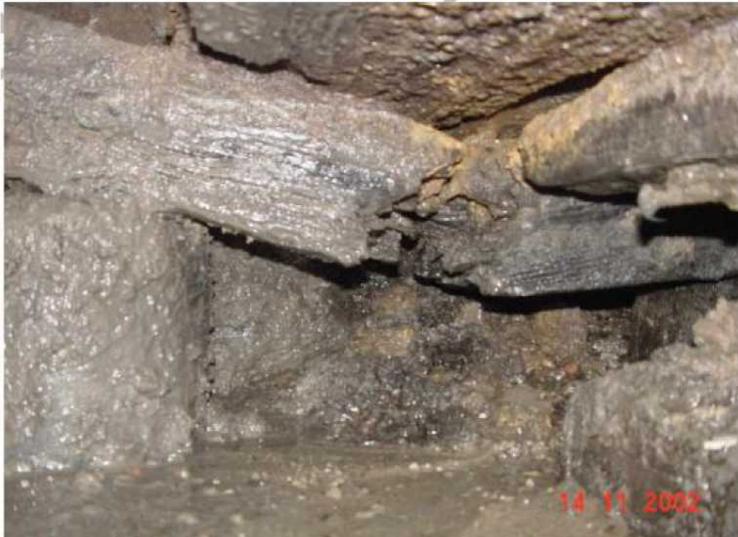
Figuur 18 Een gebroken kesp na aantasting (Amsterdamse fundering) De muur dreigt tussen de palen weg te zakken. Bron foto: Fugro funderingsonderzoek
